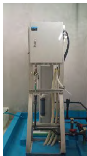
給水地点に設置されている水質自動測定器
