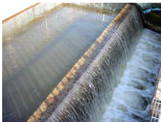
浄水場着水井(原水:浄水場入口)
