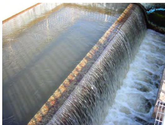
浄水場着水井(原水:浄水場入口)
