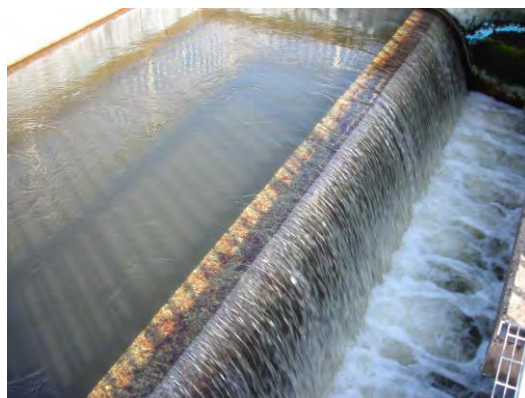
浄水場着水井(原水:浄水場入口)
