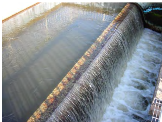
浄水場着水井(原水:浄水場入口)
