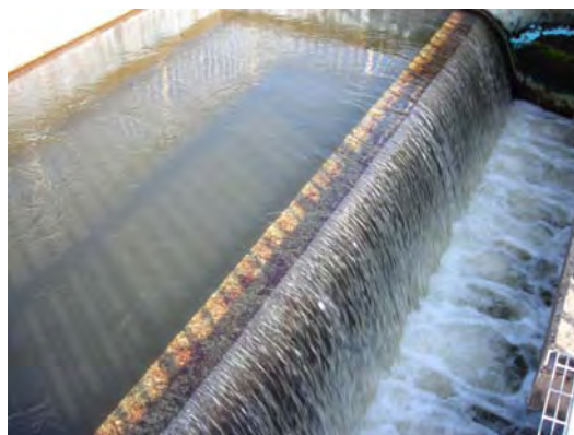
浄水場着水井(原水:浄水場入口)
