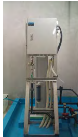
給水地点に設置されている水質自動測定器
